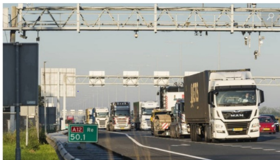
Waar nodig worden matrixborden vervangen RIJKSWATERSTAAT
